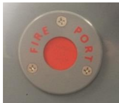
Feuerlöschöffnung auf der Backbordseite der Konsole
